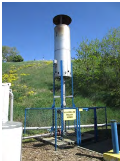
Rys. 1. Pochodnia awaryjnego spalania biogazu [źródło własne]
